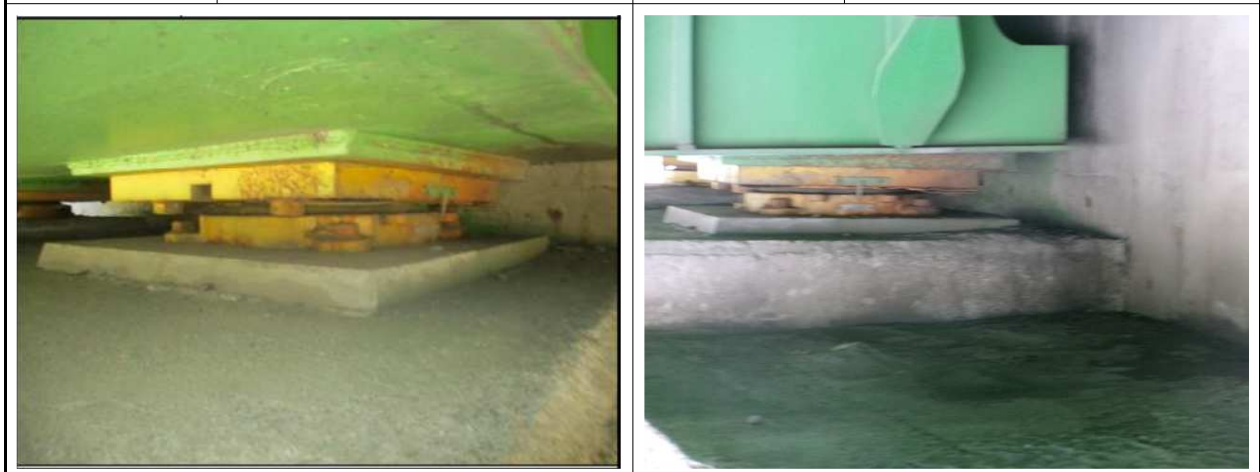
08 (25년 하반기) 받침콘크리트(A2-Sh2) 받침 부식 08 (26년 상반기) 받침콘크리트(A2-Sh2) 받침 부식
